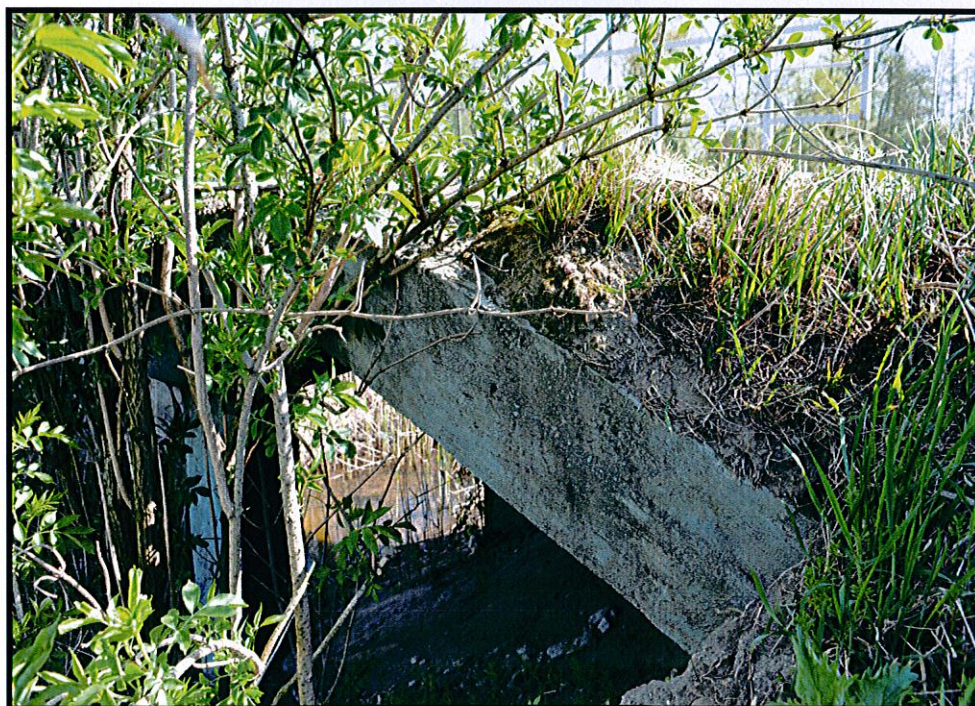
Fot. 10. Pęknięcie i odchylenie się końcowej części belki podporęczowej od strony GW
