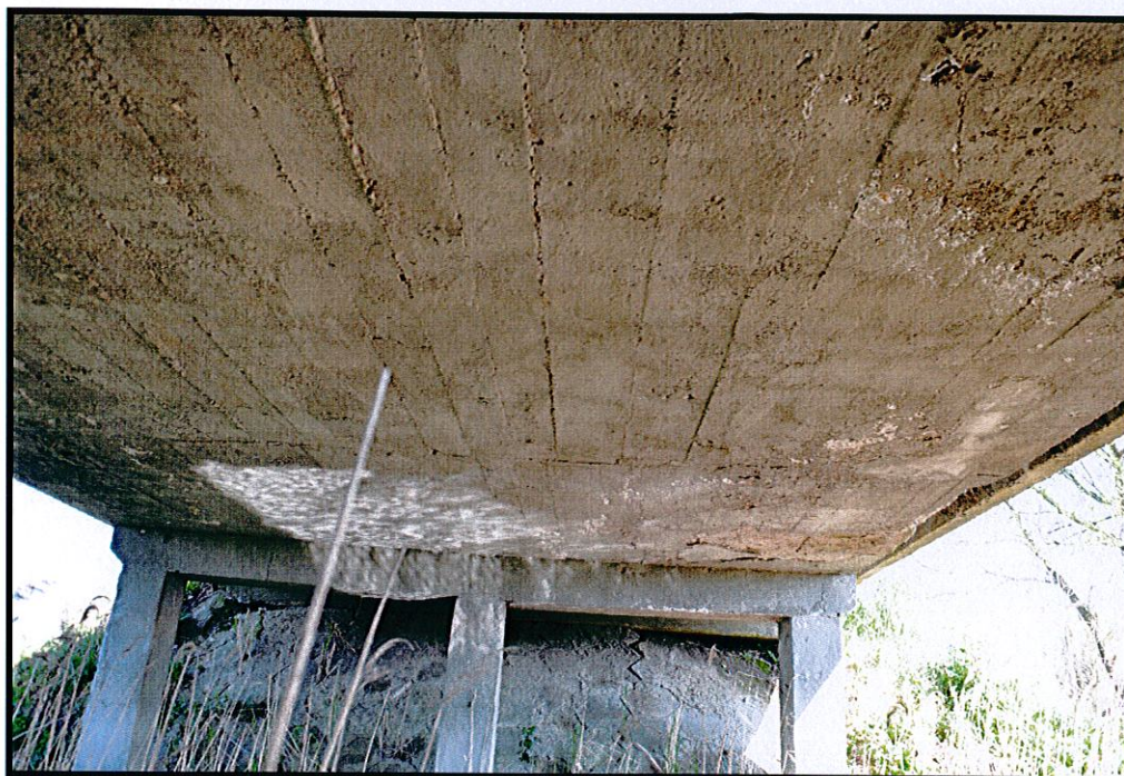
Fot. 7. Gzyms i płyta od spodu obiektu
